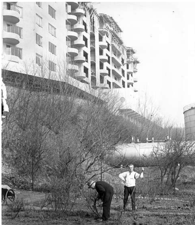
To mænd arbejder i en lille nyttehøve, mens Klintegaarden med dens runde altaner er under opførelse i baggrunden. Stadsingeniørens Kontor, ca. 1937, Aarhus Stadsarkiv.
